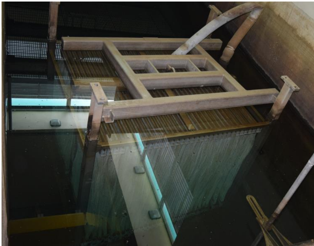
Figura 4. Casete con módulos de la membrana Zeeweed 500D. Foto tomada por Zullymar Vélez.
